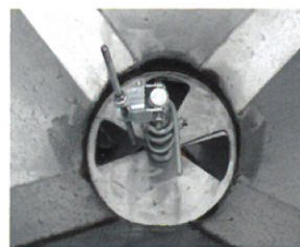
insgesamt 3 Öffnungen im Tank sorgen für eine sichere Ausbringung
